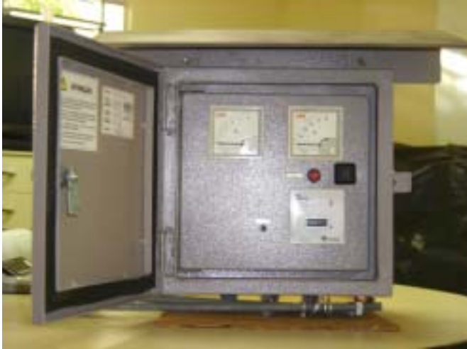
Figura 1: 1º Retificador desenvolvido para a SERGAS. Instalado e operando desde Janeiro de 2006.
